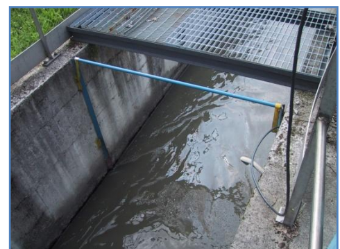
Canale di ingresso impianto di depurazione
