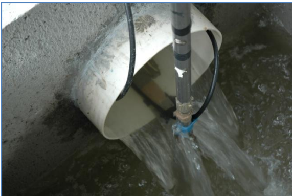
Scarico industriale con misurazione istantanea
