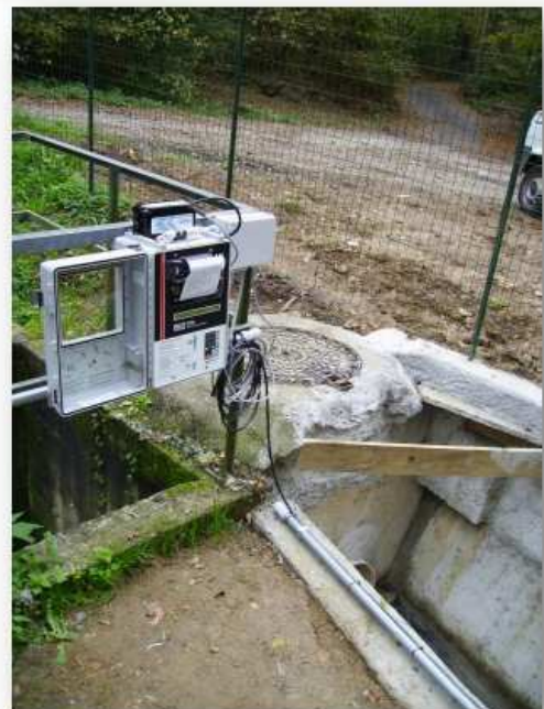
ESEMPI DI POSIZIONAMENTO MISURATORE ISCO 4250
